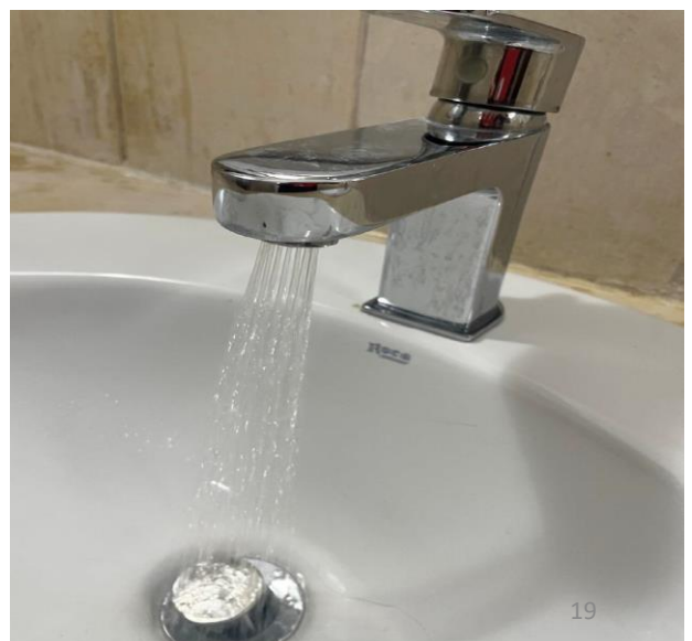
Après installation des économiseurs
